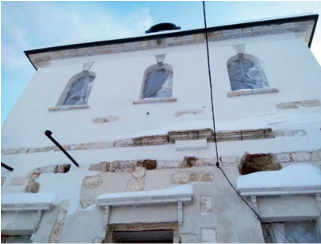
Северный фасад храма с реставрационными раскрытиями. Январь 2022 The North Façade of the Church with Openings for the Restoration. January 2022
